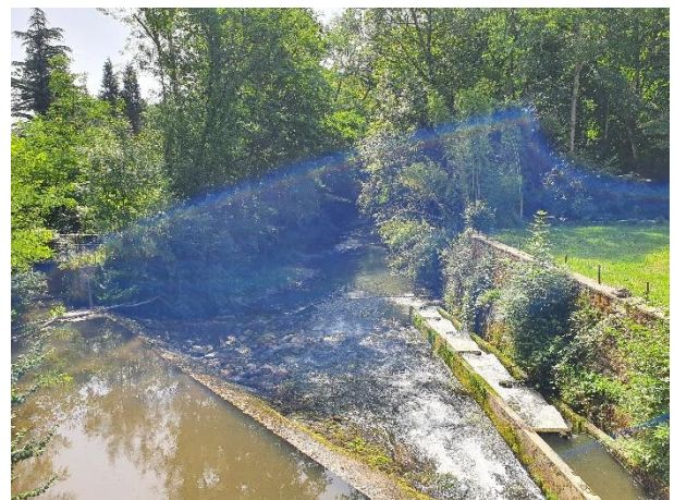
Seuil des anciennes forges équipé d'une passe à poisson en rive droite
