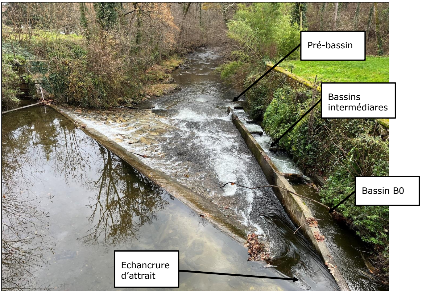
Figure 13 : Vue de la passe à poissons du seuil des Forges
