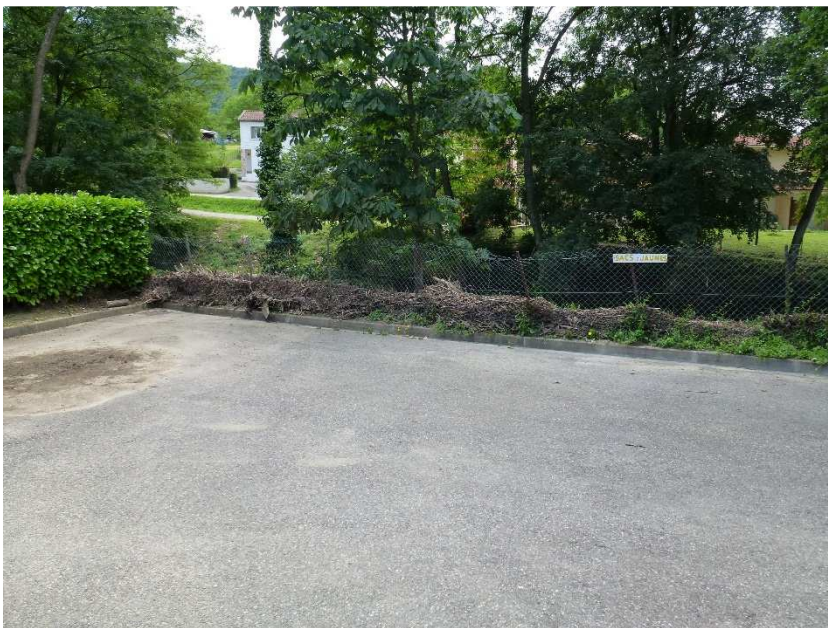
Photographie 15 : Traces témoignant du niveau atteint sur le grillage du parking de la maison de retraite la Lausada (Source : Agerin)
