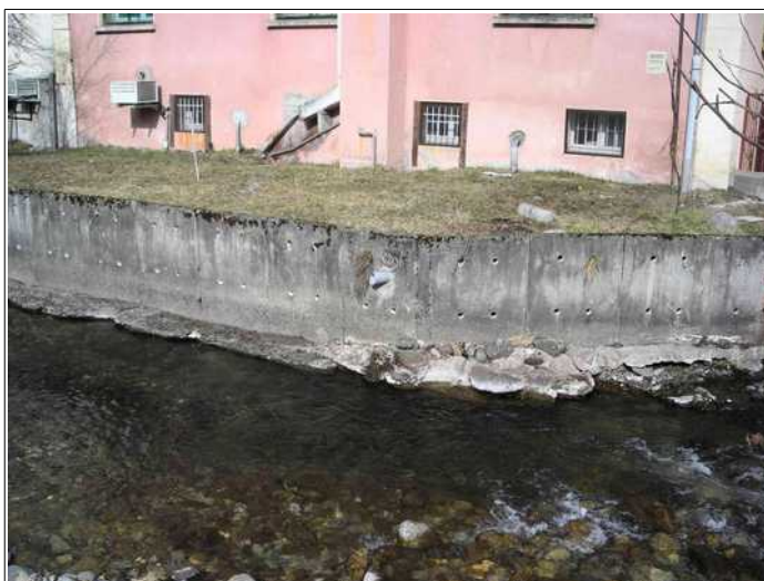
Gros plan sur le mur protégeant la rive droite du GARBET au droit du bâtiment de la colonie. On notera l'affouillement des fondations.
