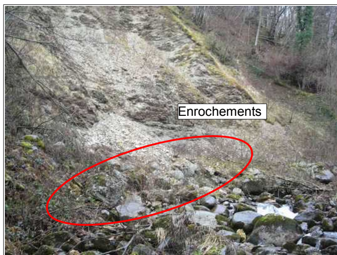
Rive droite du FOUILLET érodée au droit de la RD8f. Un cordon d'enrochement a été mis en place pour protéger la berge.
