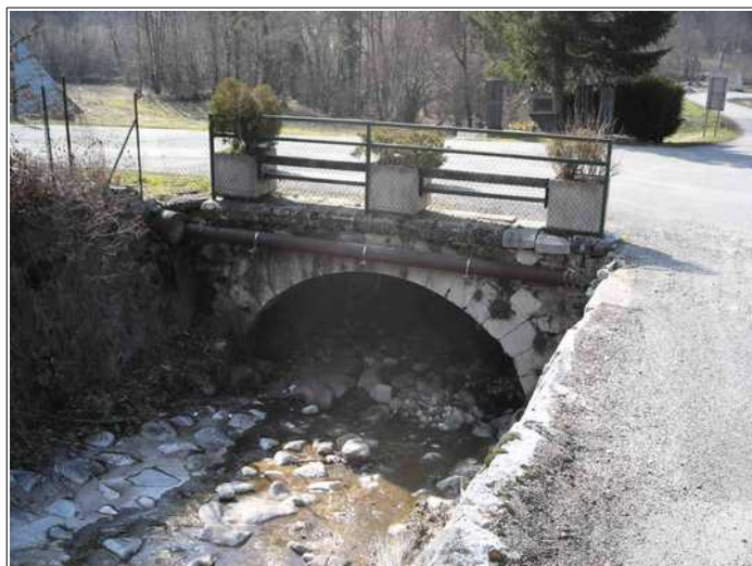
Pont de la RD8f en partie encombré par les sédiments du torrent.
