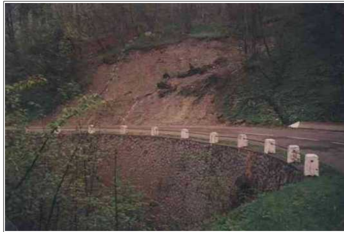
Glissement de talus de la RD8f (route du col de LATRAPE) en 2001 au franchissement du ruisseau des FOURSONS.
