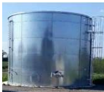
Réserve eau incendie
