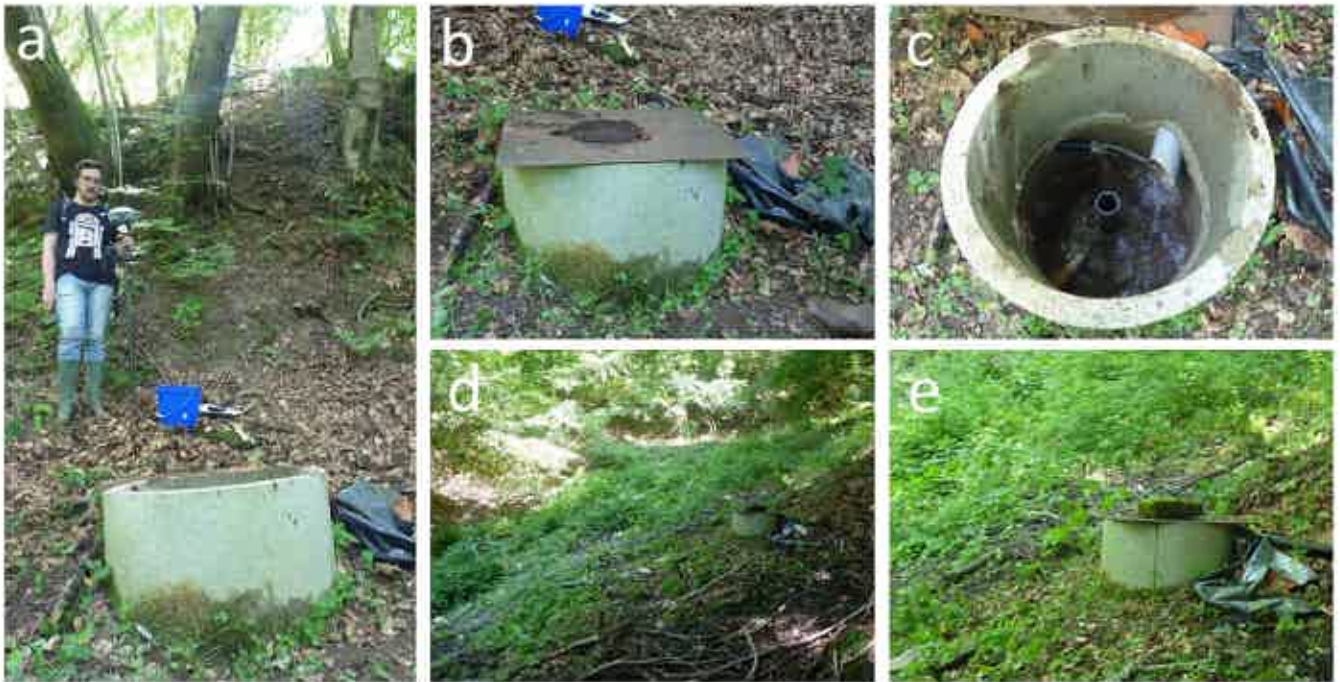
Figure 6 : Captage de Lamousquere Sup Nardiou : ouvrage de captage (a, b), intérieur du captage (c), environnement du captage (d et e)
