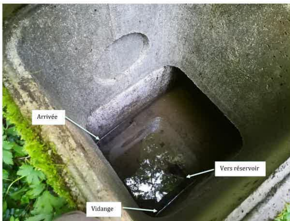
Illustration 19 : Cliché de l'intérieur du captage de « Lamousquère Cap réservoir » (Source : CEREG, 2019)
