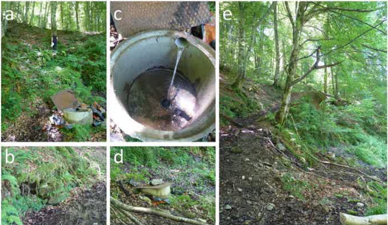
Figure 5 : Captage de Paillol : buse d'arrivée du drain (a), ouvrage de captage (b), intérieur de la buse d'arrivée (c), environnement du captage (d et e)
