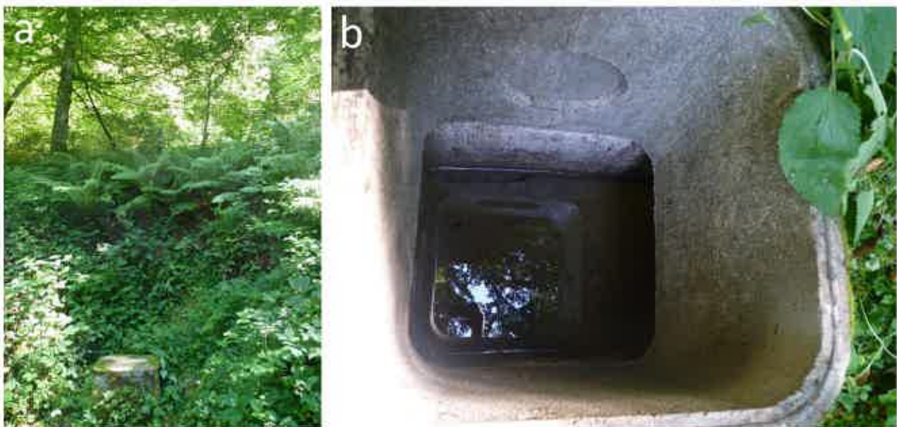
Figure 7 : Captage de Lamousquere Cap réservoir : ouvrage de captage et environnement.
