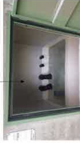
Photo intérieure du Mélange Captage de Palette
