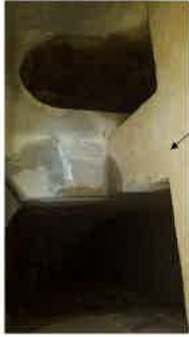
Photo intérieure du Captage Palette.
