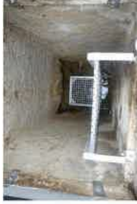
Captage 3 (en antenne)
