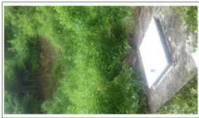
Captage de Barreille
