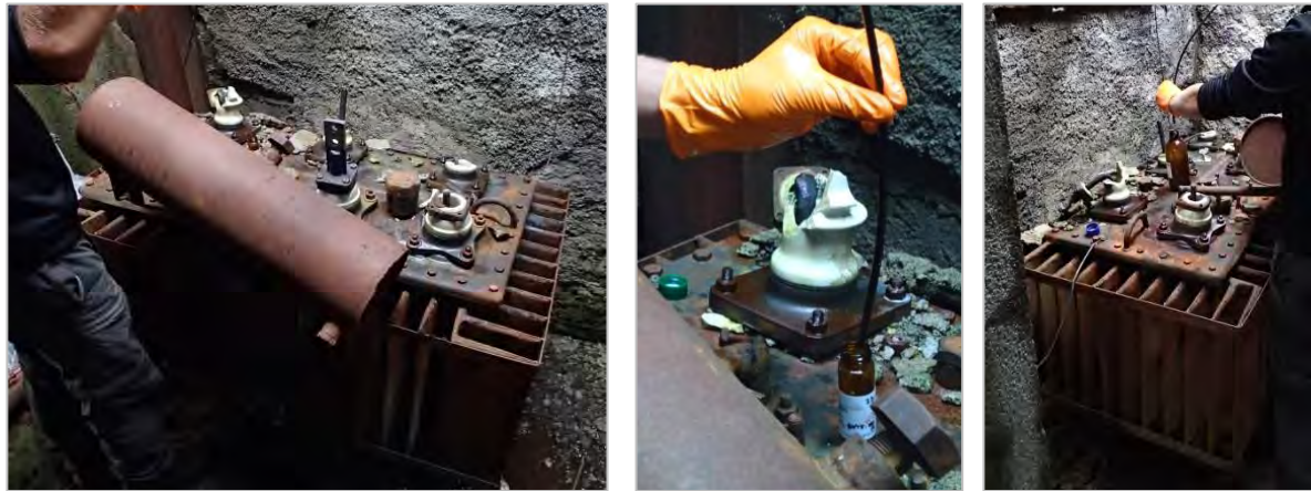
Echantillonnage des huiles contenues dans le transformateur T2 avec tuyaux flexible et seringue. Remplissage immédiat des flacons en verre brun. Au droit du poste de transformation de Bentaillou.
