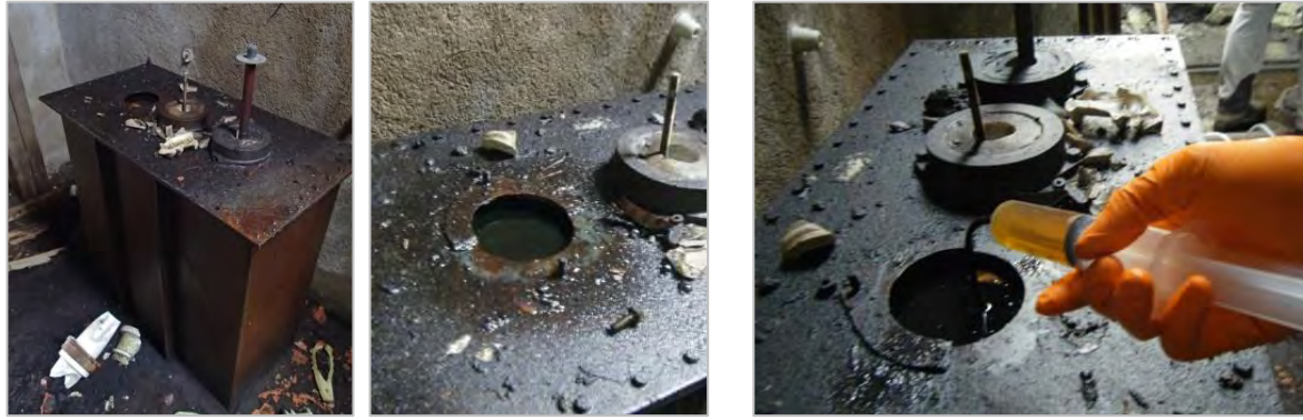
Echantillonnage des huiles contenues dans le transformateur T3 (déjà ouvert lors de l'arrivée sur les lieux) avec tuyaux flexible et seringue). Au droit du poste de transformation de Bentaillou.
