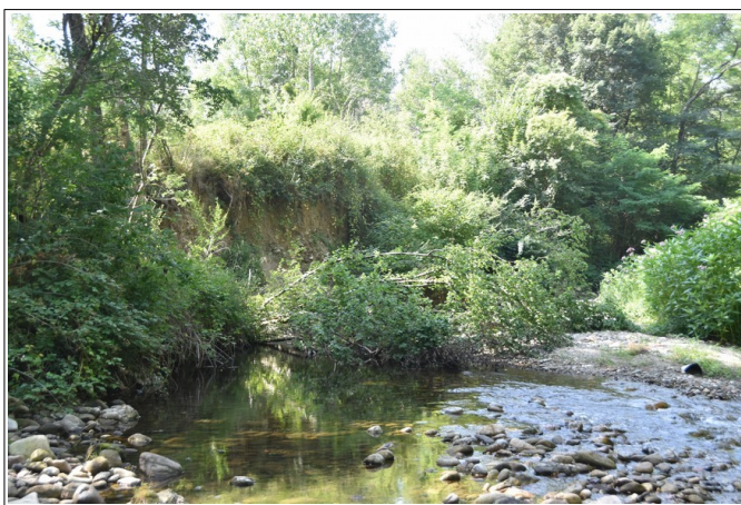
Figure 3.10: érosion de berge en rive droite sur le tronçon compris entre la zone d'activité et la station d'épuration.
