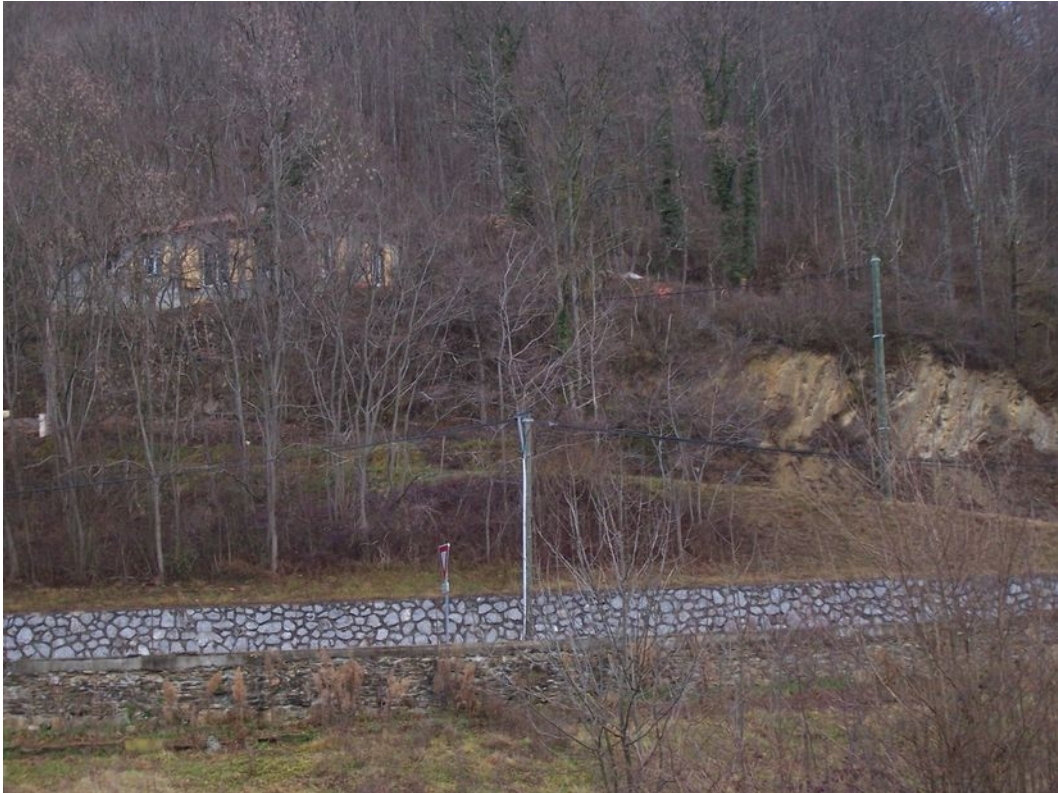
Illustration 8: pied de la route menant au lieu-dit de Montcamp, arrachements localisés dans les marnes gréseuses
