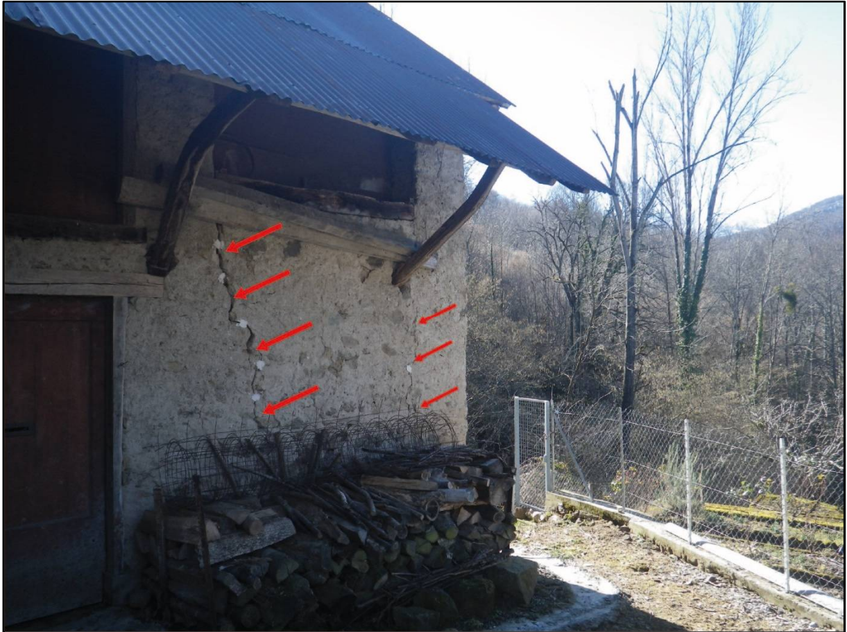
Figure 14 : Fissures sur le bâtiment le plus à l'aval du hameau de Lafite (source : AGERINsas)
