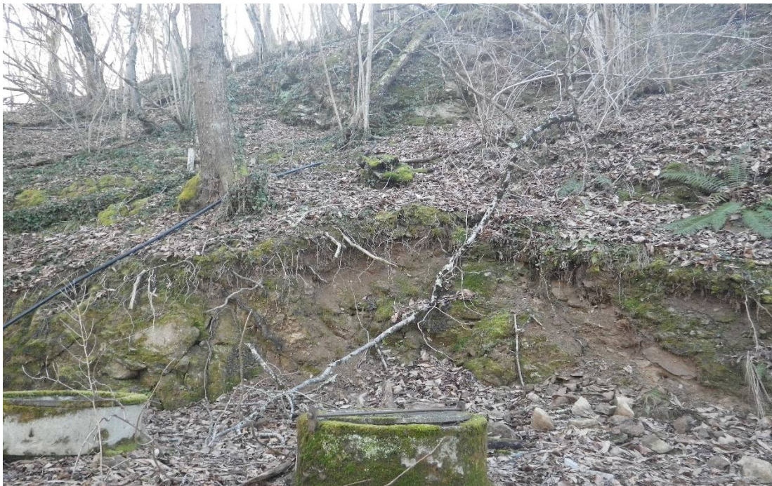
Figure 18 : Chutes de blocs près de Costes (source : AGERINsas)
