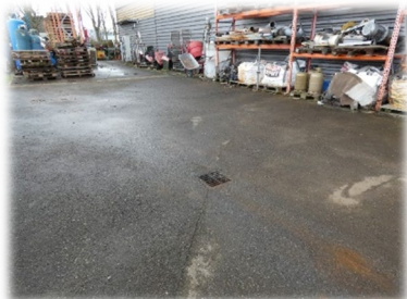
Grille sur la zone de stockage ferraille
