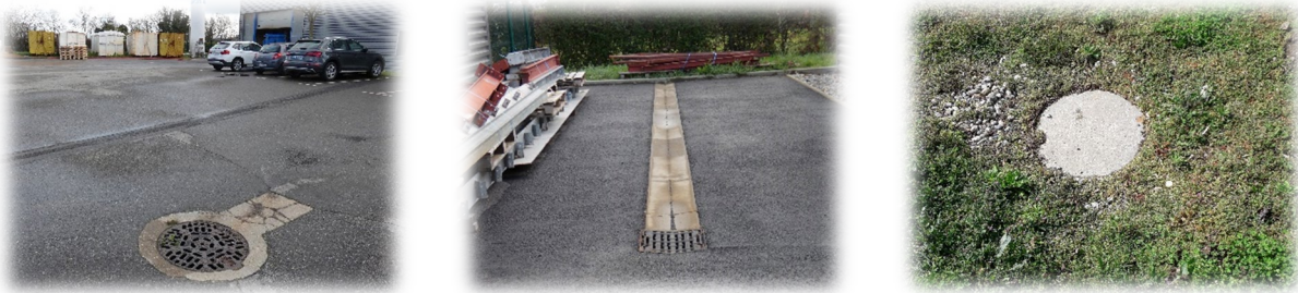
Illustration 29 : avaloirs (à gauche et au centre) et puit sec (à droite) au sein du site d'étude (© ECTARE)
