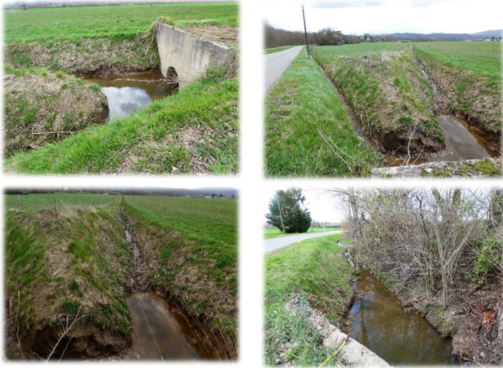
Le ruisseau de la Fage, au niveau de la traversée de la RD 10 à l'amont de la route de Verniolle, 750 m au sud-est du site d'étude (© ECTARE du 16/03/2021)
