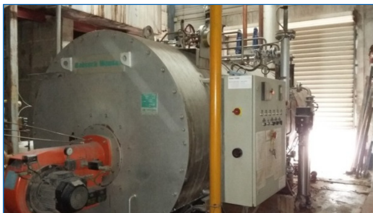
Figure 6 : Vue de la chaudière au gaz (source : photo BURGEAP – visite du site du 12/07/2017)
