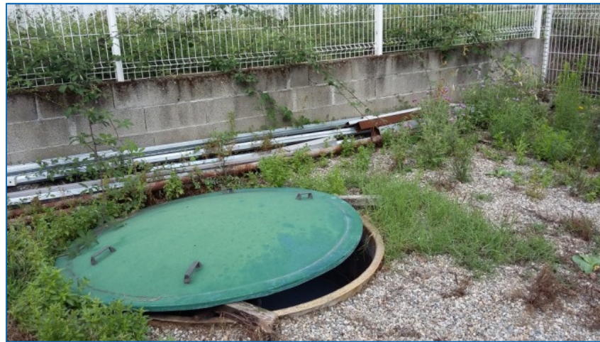
Figure 7 : Visualisation de la cuve de stockage des effluents avant rejet au réseau communal (source : BURGEAP – visite du site du 12/07/2017)
